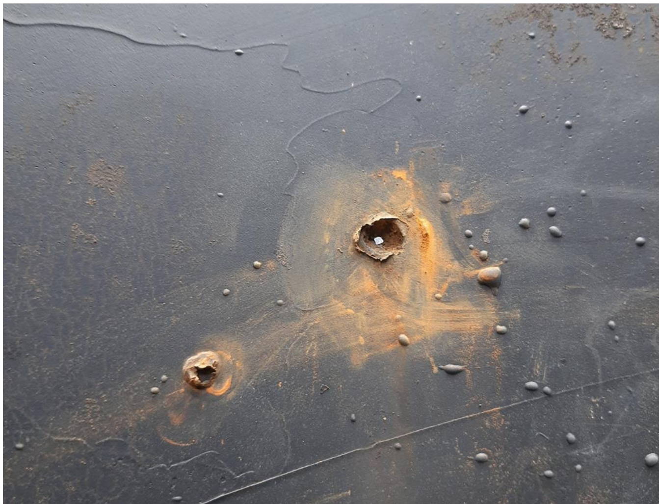
Korrosion beim SBR 1: der Aussendurchmesser beträgt ca. 1 cm das durchgehende Loch ca. 1 mm
