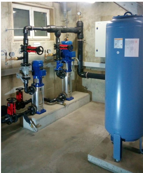
Neue Brauchwasseranlage, links Druckerhöhungspumpen, rechts Druckbehälter
